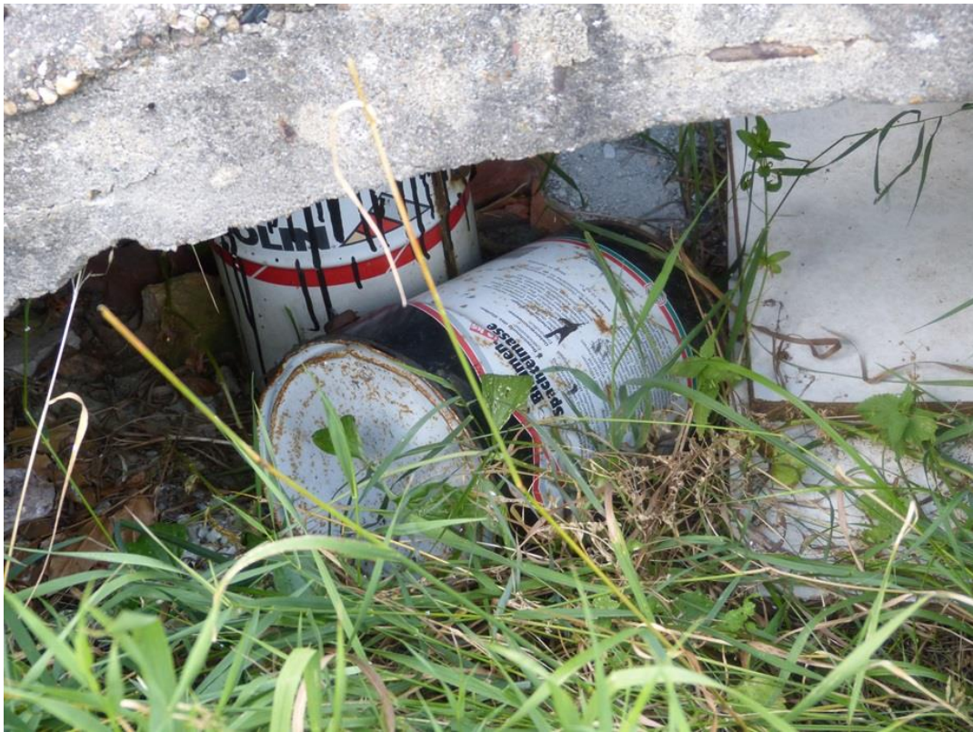
Bild 21: Müll unterhalb der Beton-Halbschalen
