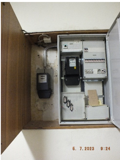
alter Elt-Anschluss (muss erneuert werden)
